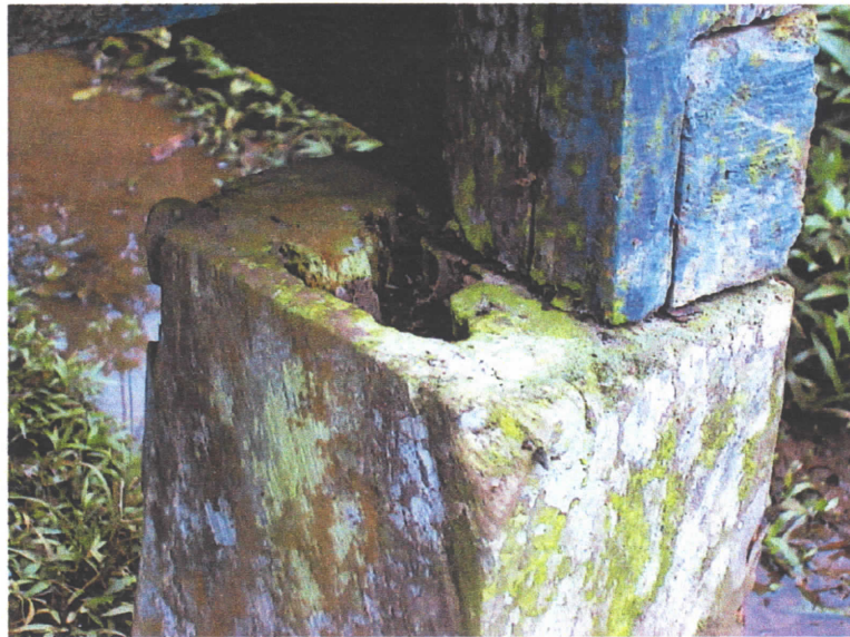
Fotografía 1. Base de casa en mal estado, nótese el desplazamiento lateral.
